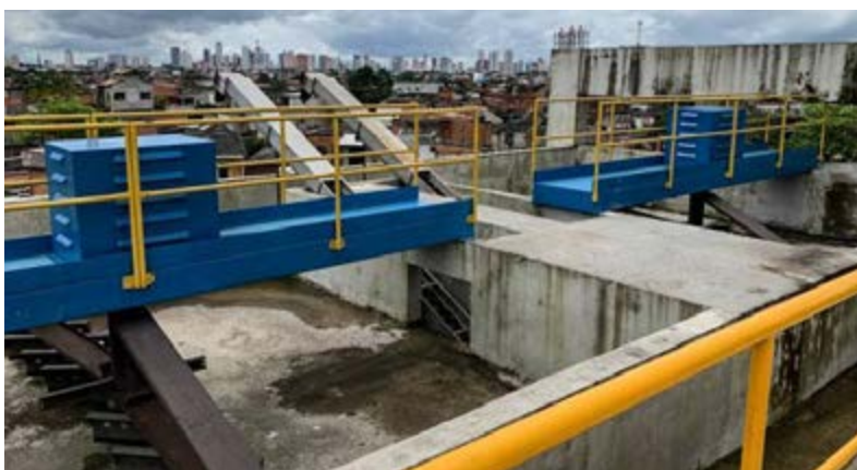
Novo Sistema de abastecimento de água de Afuá ; e Obras da Estação de Tratamento de Esgoto (ETE) Una/Belém.
