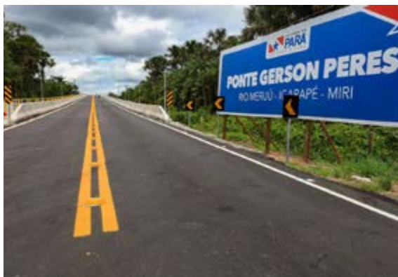
PA-407(Rodovia do Açai) e Ponte do Rio Meruú.
